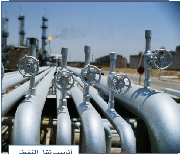
أنابيب نقل النفط
